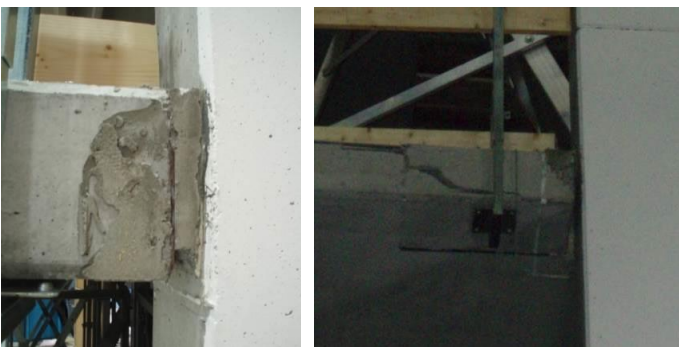
Figure 10. Detail of one beam-to-wall connection after the test with PGA of (a) 0,15g, (b) 0,30g / Dettaglio di una connessione trave-muro dopo la prova con PGA di (a) 0,15g e (b) 0,30g.
