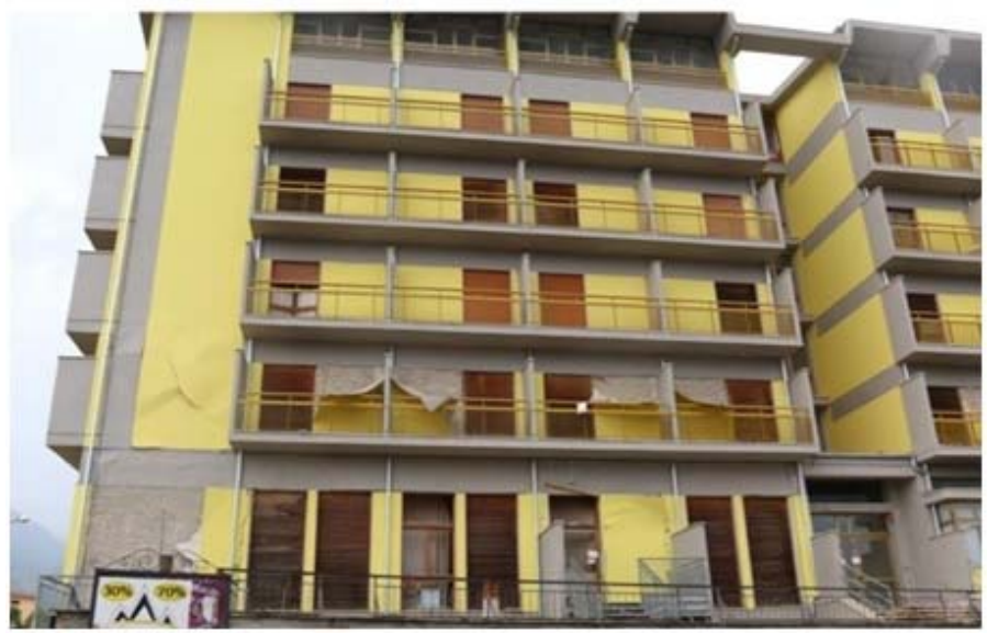
Figura 12: Edificio in c.a. evidenziato in Figura 7 post evento sismico (da [3]).
