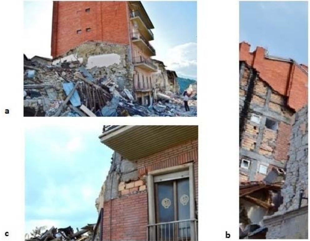
Figura 10: a) Danni subiti dalle tamponature ortogonali al corso Umberto I; b) danni subiti dalle tamponature ortogonali al corso Umberto I con evidente distacco dell'involucro esterno in mattoni rossi; c) dettaglio danni nel nodo in c.a. al primo piano.
